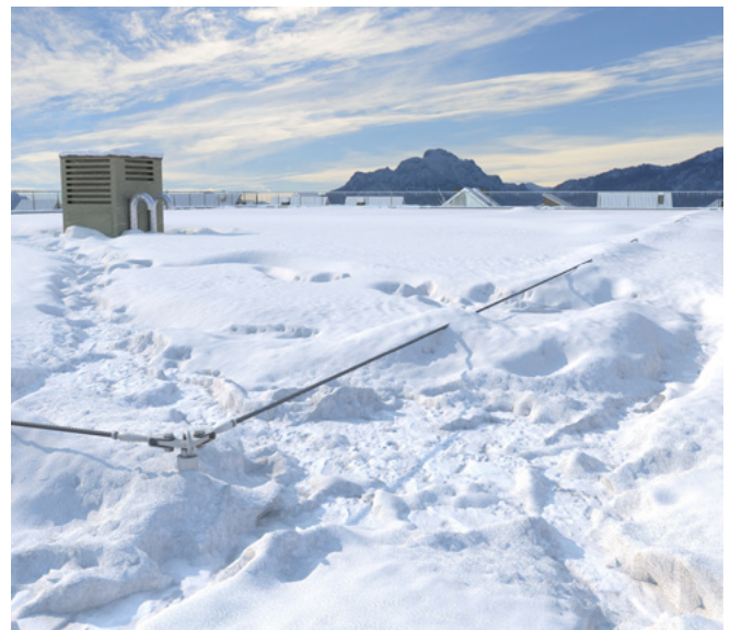
Abb. 3 Beispiel Stolpergefahr Anschlageneinrichtung
